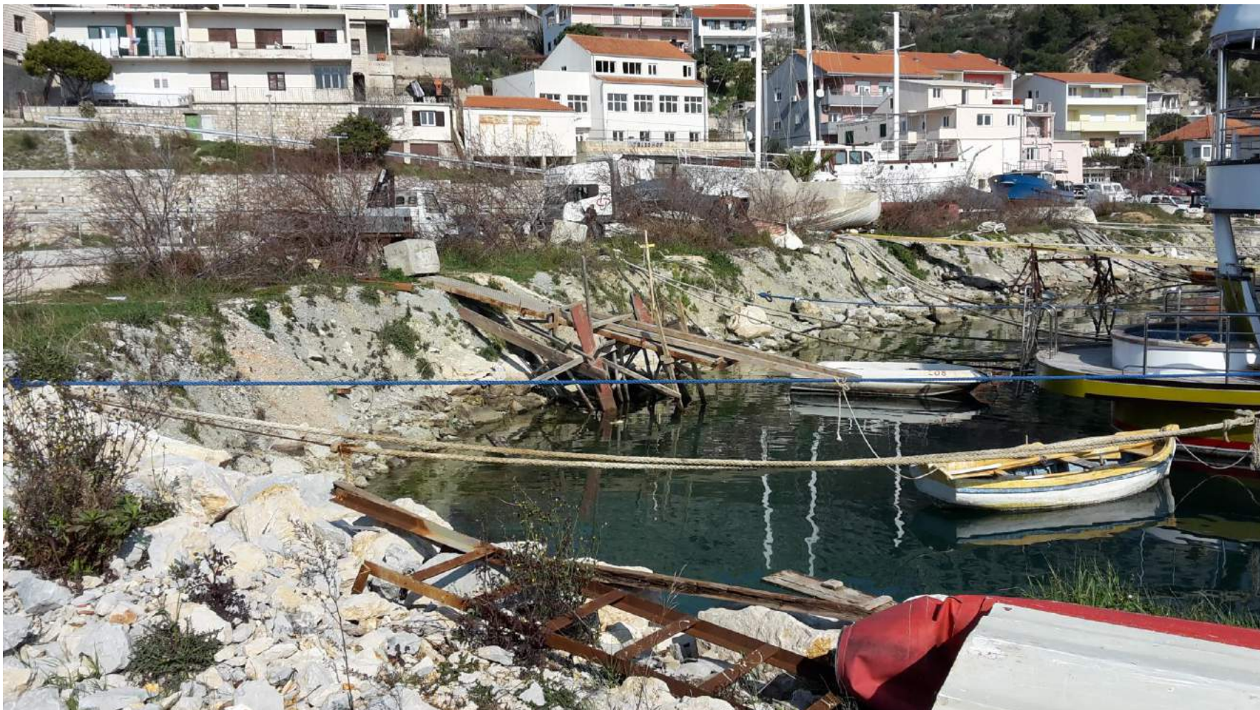
Slika 1.1.-4.: Stanje na početku postojećeg zapadnog gata
